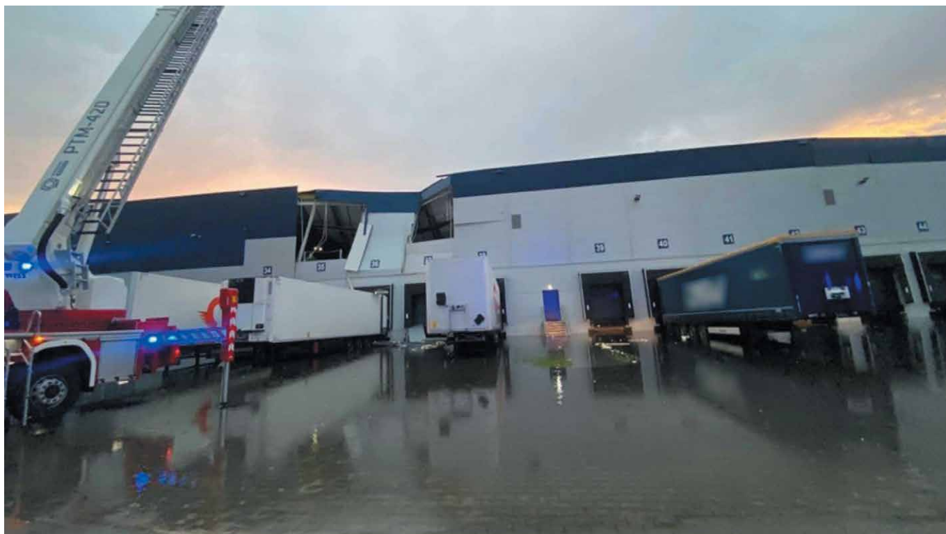
fot. 1. Szczecin. Zawalony dach hali przy ul. Kablowej [S1]
